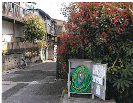
使用された街かど消火栓
