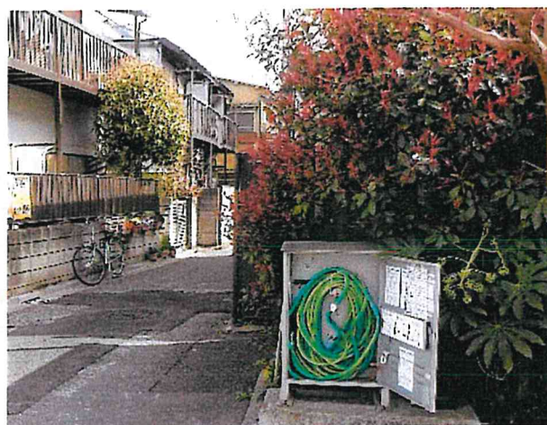
火災現場周辺と使用された街かど消火栓
